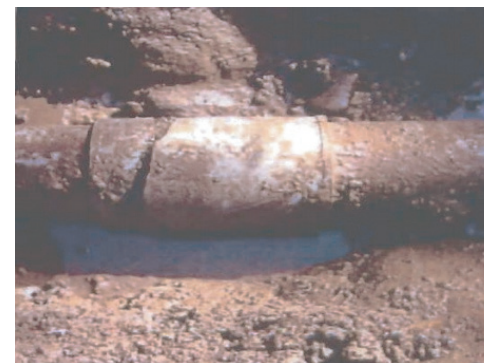
継手が破損した硬質塩化ビニル管 1)
