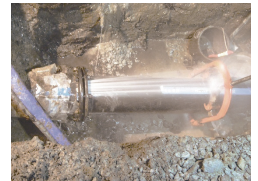
継手が抜けた鉄管 2)
